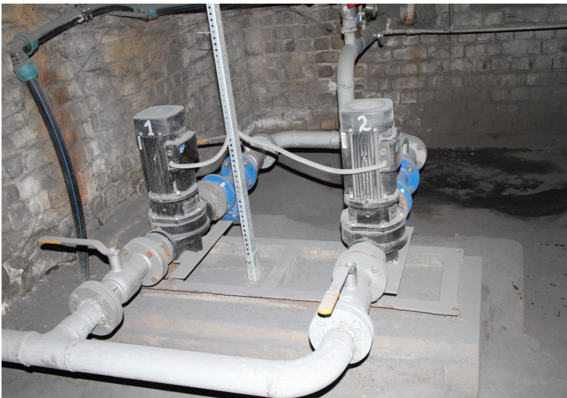
Насосная группа котельной состоит из двух циркуляционн ых насосов Grundfos TP 32-320/2.
